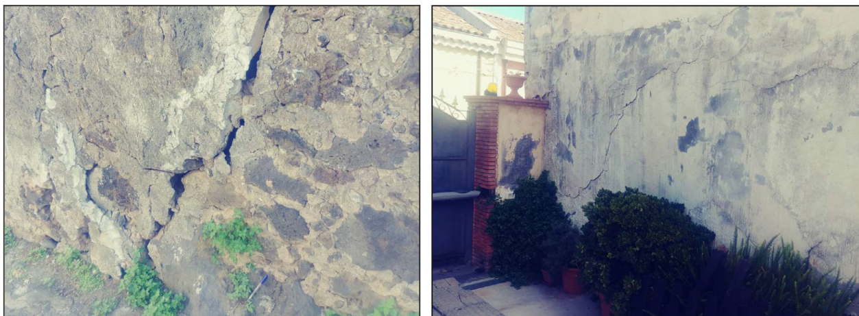
Fig. 65 – A sinistra foto con fessura beante disarticolata in corrispondenza di un fabbricato ubicato in Vico Romeo, stradina perpendicolare alla Via Marciano – A destra ala di un edificio spanciato e con una vistosa fessura inclinata in Via Marciano 30 A, ad incrocio con Vico Cavallaro – estratto da MS3
